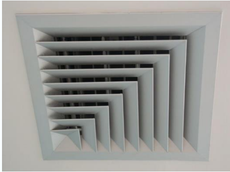
Bouche de soufflage en plafond
